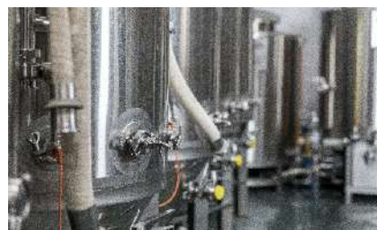
Освещение производственных помещений, складов, наружное в том числе КПП. Завод по производству зерновых (висковых) дистиллятов с спиртохранилищем ОАО «Ариант спиритс», г. Челябинск, 2023 г.
