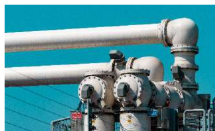
Освещение блочно-компрессорной насосной станции (БКНС-10Р) Мамонтовское месторождение, г. Нефтеюганск, ХМАО, 2023 г.
