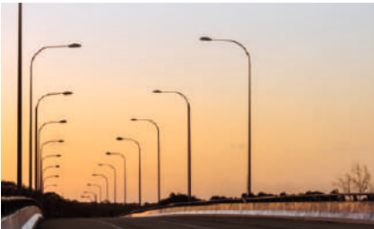
Освещение автомобильной дороги «Ульяновск-Димитровград-Самара» (км 13+046-км 2+310), Удьяновская область, 2012 г.
