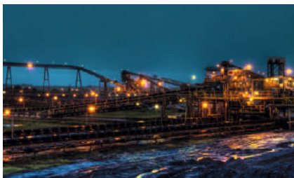
Наружное освещение производственных площадок ООО «СОМЭКС», Московская область, 2020 г.
