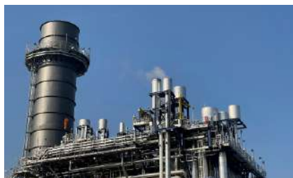
Охранное освещение южной и северной площадок ООО «Афипский НПЗ», Краснодарский край, 2022 г.
