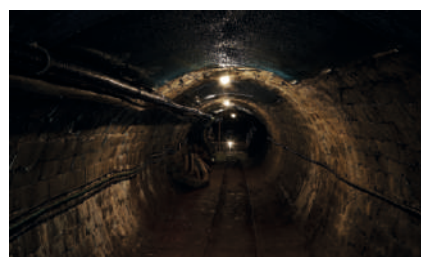
Освещение ЗАО «Южуралзолото», г. Пласт, Челябинская область, 2014 – 2020 гг.
