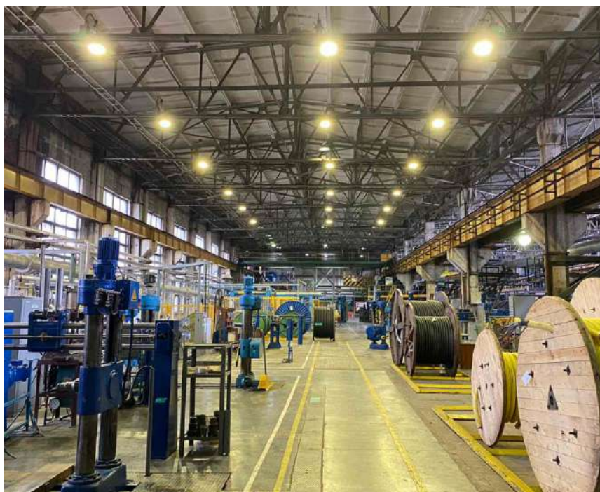
Освещение цехов ООО «Камский Кабель» г. Пермь, 2022 г.
