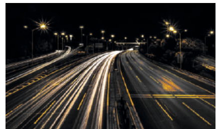
Освещение автодороги Р-193 Воронеж-Тамбов км 110+898 – км 119+000, Тамбовская область, 2014 г.
