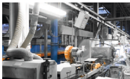
Освещение цеха сыпучих материалов и теплового цеха ООО «Дюккерхофф Коркино Цемент», п. Первомайский, 2020 г.
