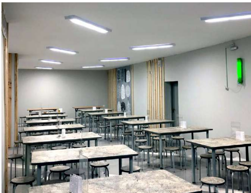
Освещение школьной столовой СОШ №10 г. Челябинск, 2020 г.
